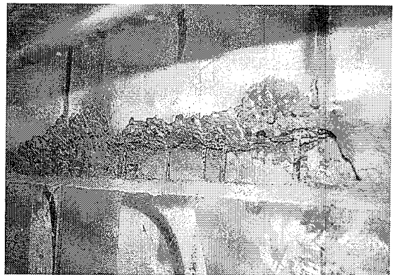
【写真1】 コンクリート水平打継部のジャンカ
